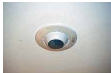
Detector de presencia. Fuente: Elaboración propia.
