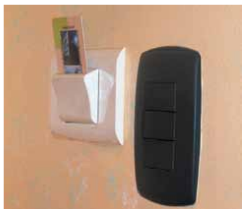
Interruptor de tarjeta. Fuente: Elaboración propia
